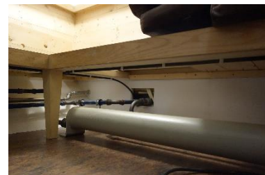
Sentralvarme under benker med vann fra fyrkjele
