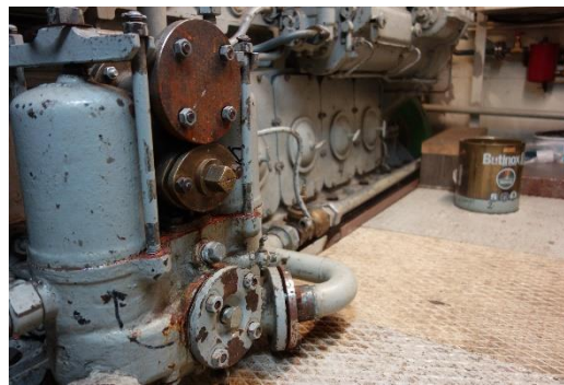
Bildet over viser lensevannspumpa og reserve lenserørforbindelse til sump ved svinghjulet. Det er direkte koblet til lensepumpe og fungerer som et nødlensesystem v. stor vanninntrengin
